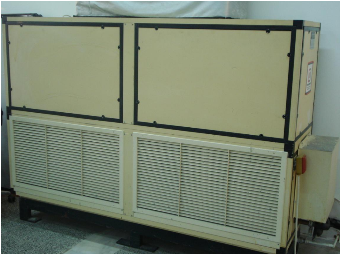
Εικόνα 3.14 Το κλιματιστικό που χρησιμοποιήθηκε
