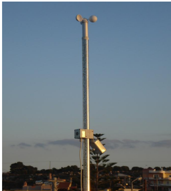
Εικόνα 3.7 Οι αισθητήρες του weather station τοποθετημένοι στην τάρτασα του εργαστηρίου
