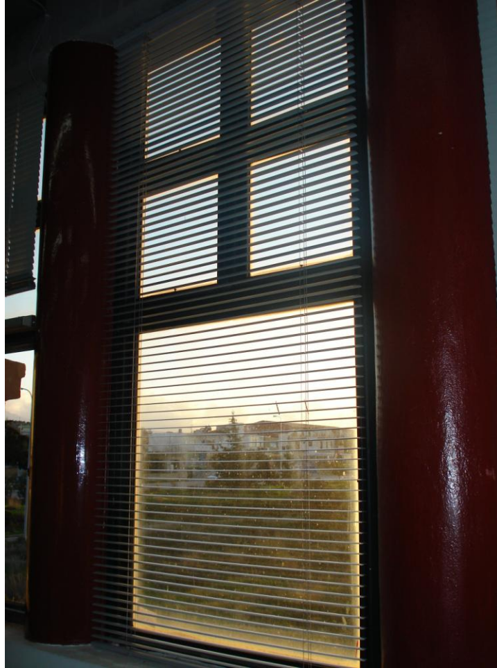
Εικόνα 3.13 Ηλεκτρικό σκίαστρο εγκατεστημένο στο εργαστήριο
